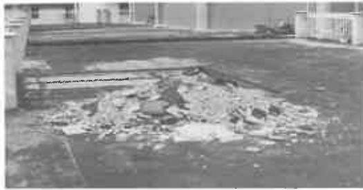
Intervento già effettuato per evitare infiltrazione d'acqua.
